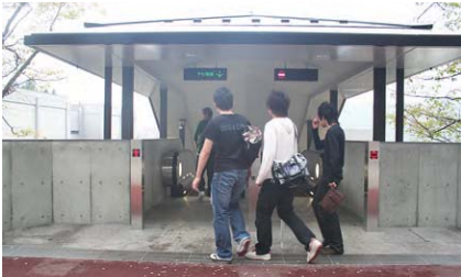
8号館(並楽館)前エスカレーター (平成21年9月28日竣工)
